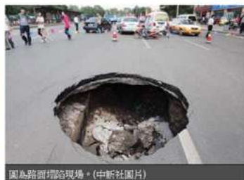
圖為路面塌陷現場。(中新社圖片)
